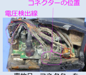
事故品 コネクターを中心とした焼損部
